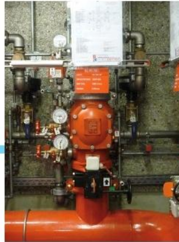
Poste de contrôle Fire sprinkler control valve assembly
