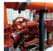
Pompe de secours Backup pump
